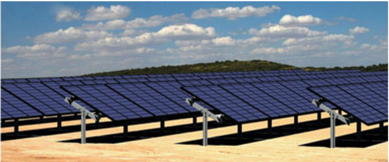
VISTA EN PERSPECTIVA DEL SISTEMA FOTOVOLTAICO.
